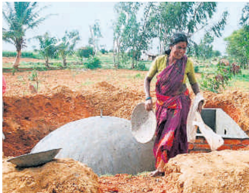
Diese Inderin aus dem Bezirk Bagepalli hilft beim Bau einer Biogasanlage, die ihr jeden Tag vier Stunden Strom zum Kochen liefert. Bild: pd
